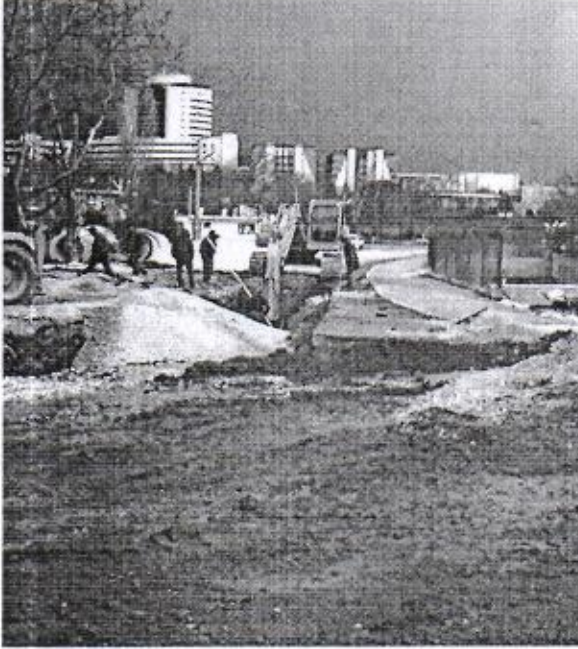
Pamukkale Üniversitesi Bölgesi Su Patlağı Çalışması.
